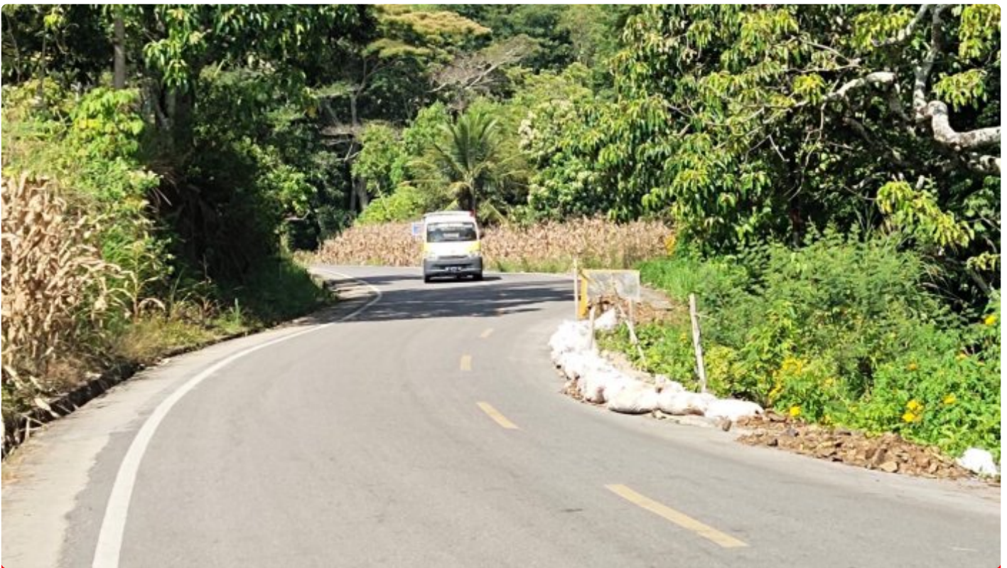
Bdan Jalan Amblas di Jalinsum Tomok-Pangururan Desa Marlumba Kecamatan Simanindo
